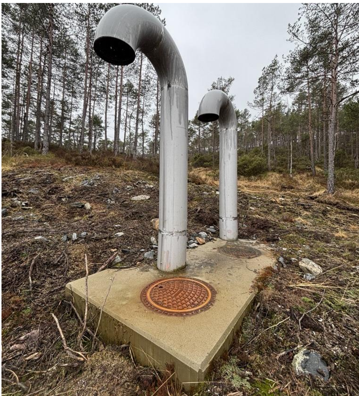
Figur 7. Teknisk installasjon som stedvis ble observert i området.
